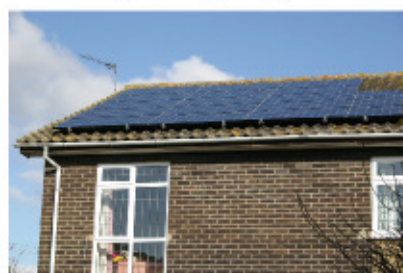
Fig.6.5: Photovoltaik: Daten eines 25 m 2 Modulfeldes in Cambridgeshire aus 2006. Als Spitzenleistung liefert dieses Feld etwa 4 kW. Der Durchschnitt übers Jahr liegt bei 12 kWh pro Tag. Das sind 20 W pro Quadratmeter Modulfläche.
