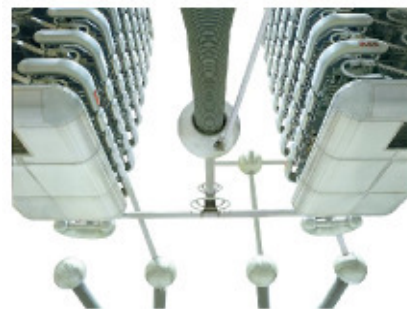
Fig.25.13: Eine HVDC Anlage in China. Foto: ABB
